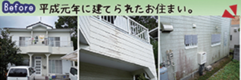
Before 平成元年に建てられたお住まい。バルコニー部の外壁が傷み、塗膜が剥がれている状況でした。
